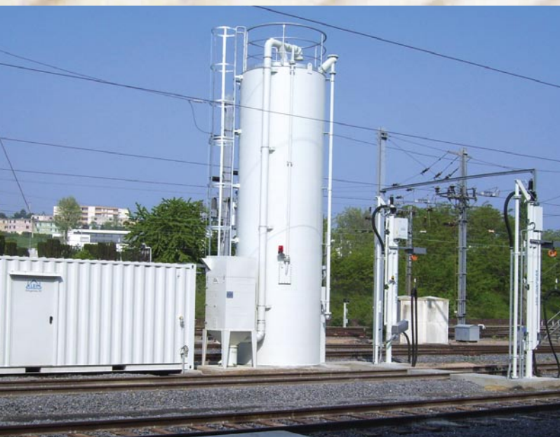
Besandungsanlage mit Kompressorstation im Container, Bremsandvorratssilo mit Filteranlage und zwei Besandungsstationen Typ kleinSAND.max stehend
