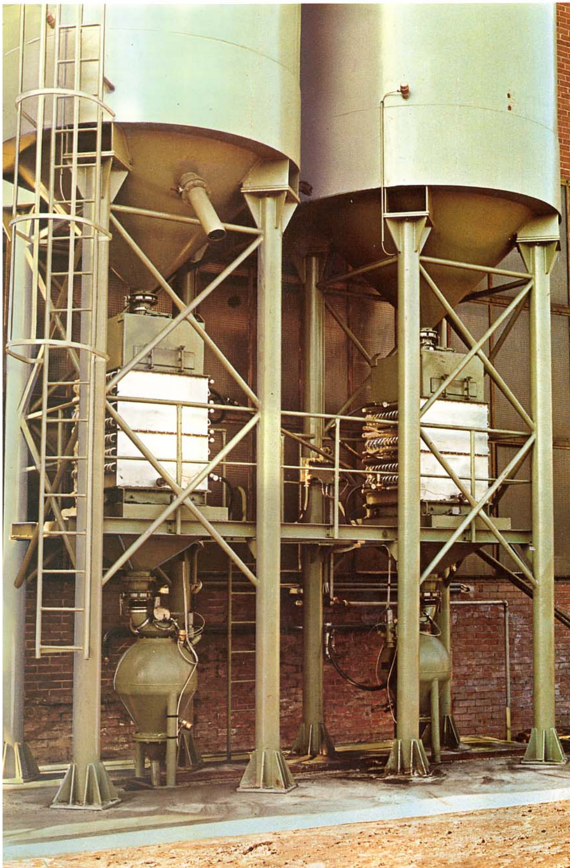
Einsatz-Foto von 2 Rückstau-Kühlern Typ Kü 199 unter zwei Altsand-Silos
